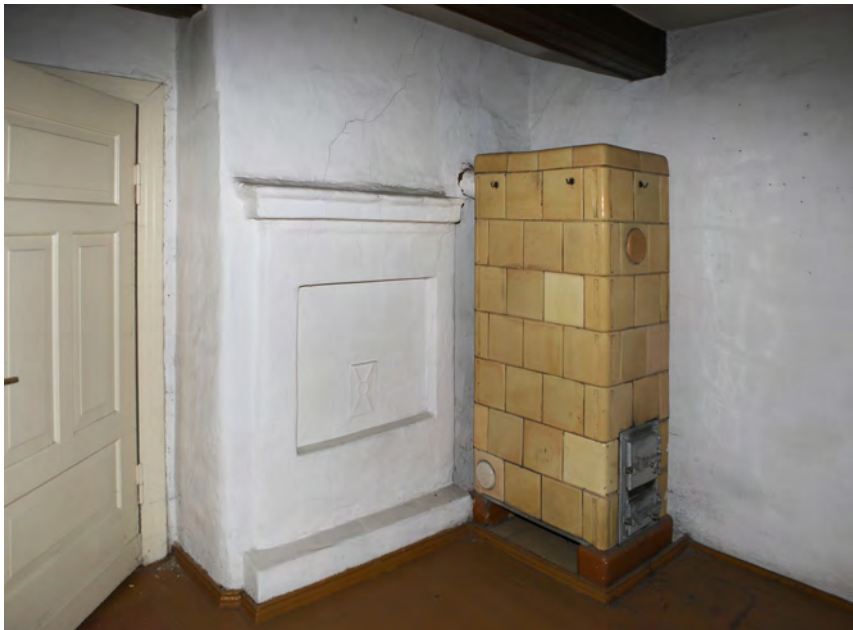
Il. 6 a-b. Strop i kominek w budynku narożnym – stan obecny. Fot. Zdzisław Nowakowski
